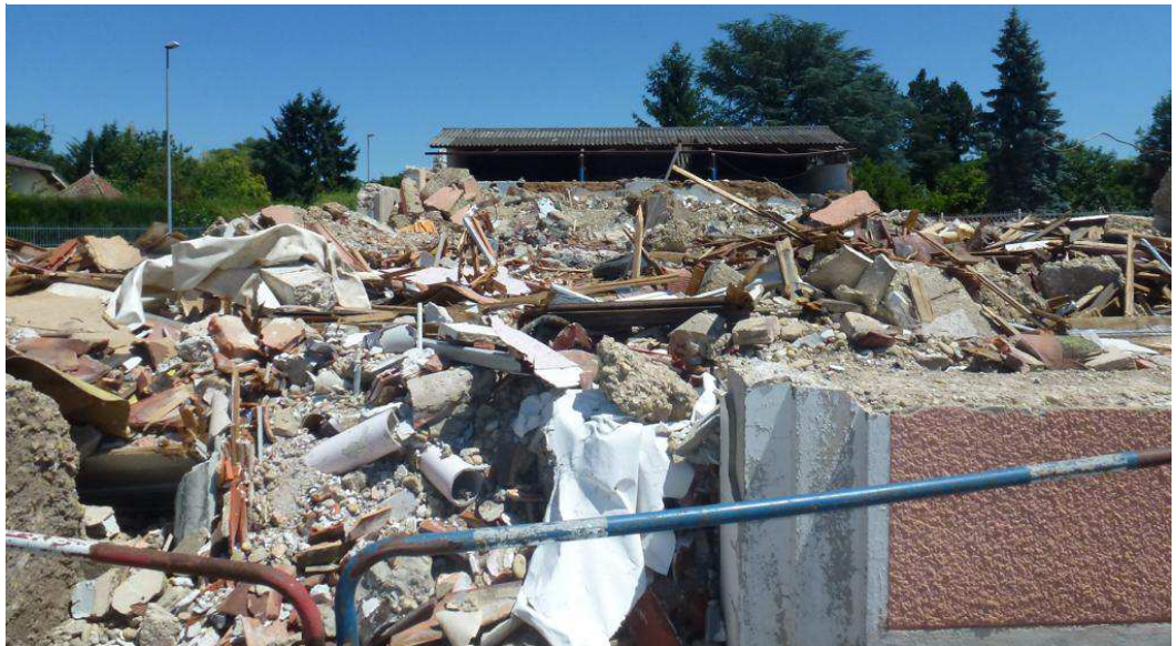
■ Des conduites en matériaux amiantés ont-elles été démolies sans respecter les dispositions de retrait de l'amiante ? Photo Fabienne Python
